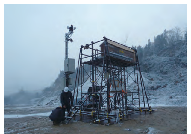
ビデオカメラは左側ポールの上に設置されています。
