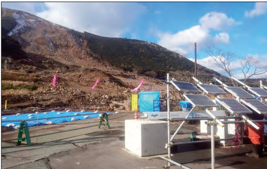
熊本県南阿蘇村で発生した地すべりのモニタリングの様子。積雪を気にしなくていいので、低い面に機器を設置しています。
